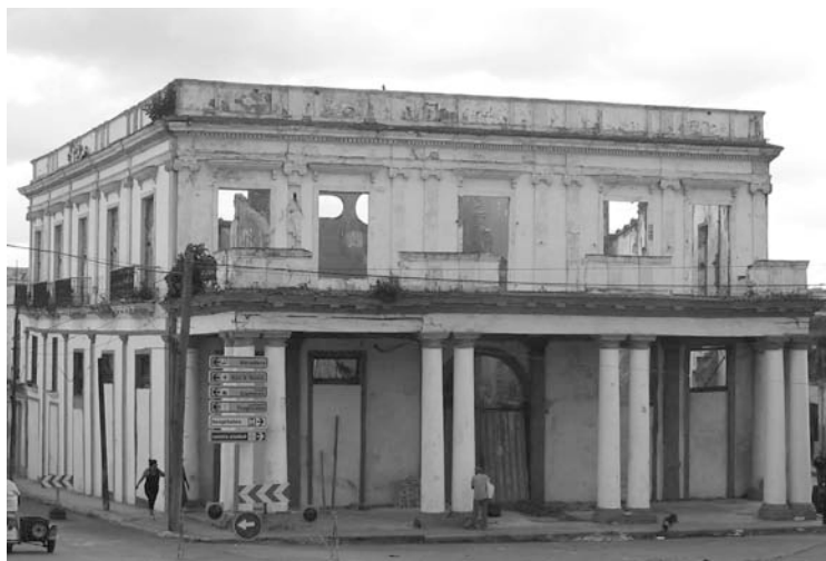
Figura 9. Inmueble del siglo XIX de la ciudad de Matanzas, Cuba, conocido como el “Edificio de los Cien Mil Pesos” en la etapa de abandono que conllevó a un deterioro en aumento hasta su demolición en 2009
