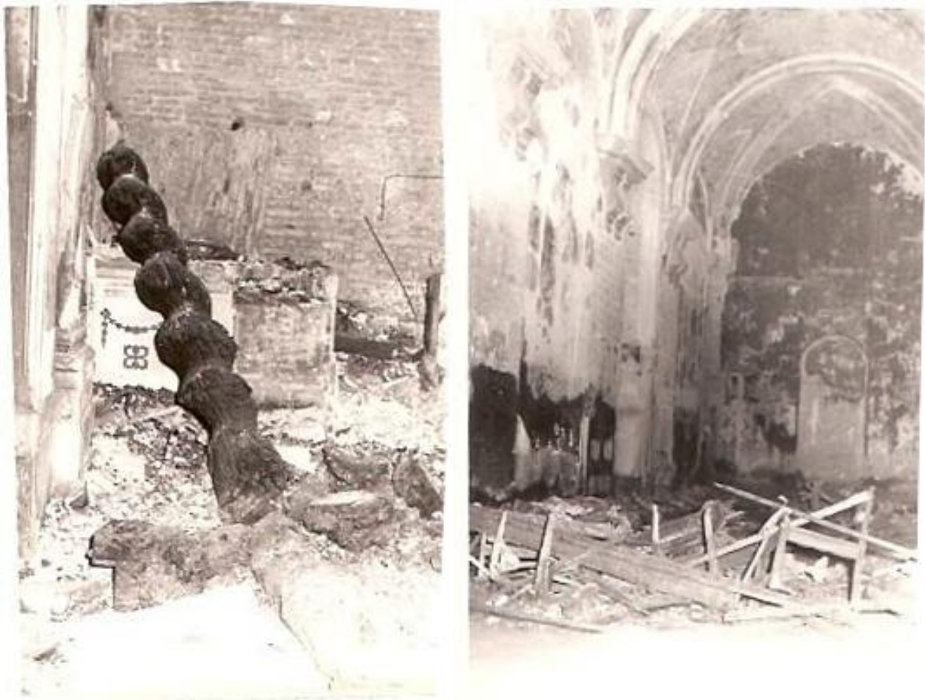
FIG. 2. Vistas del altar mayor y sacristía de San Francisco luego del incendio. Foto: Archivo CAU
